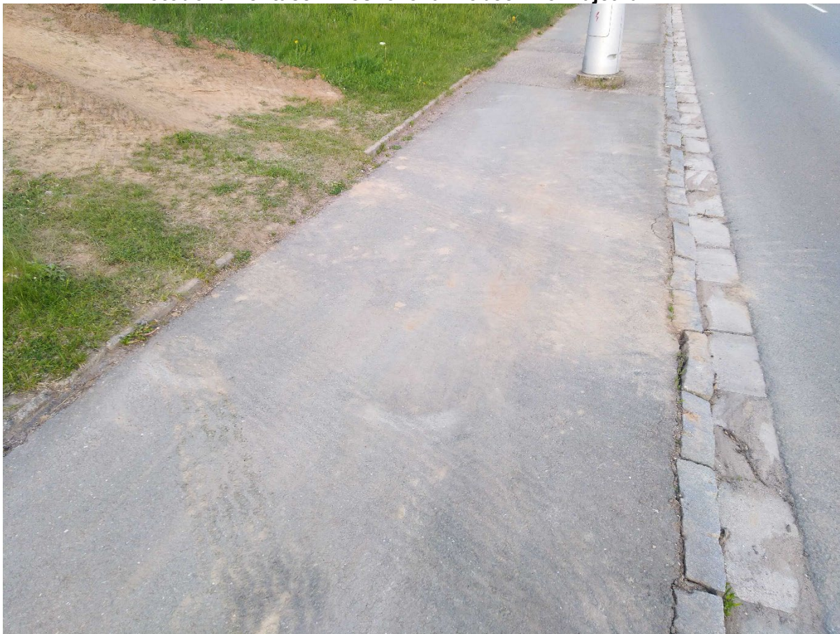
Chodník poškozený průjezdem těžké zemědělské techniky (foceno 29. 4. 2022)
